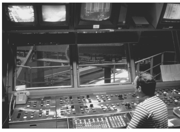
Figura 73.12 • Sala de control del proceso de colada continua.
