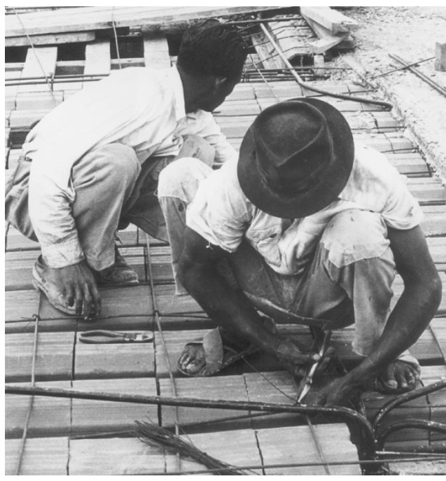
Figura 93.3 • Trabajador de la construcción en Nairobi, Kenya, sin casco ni calzado de protección.
