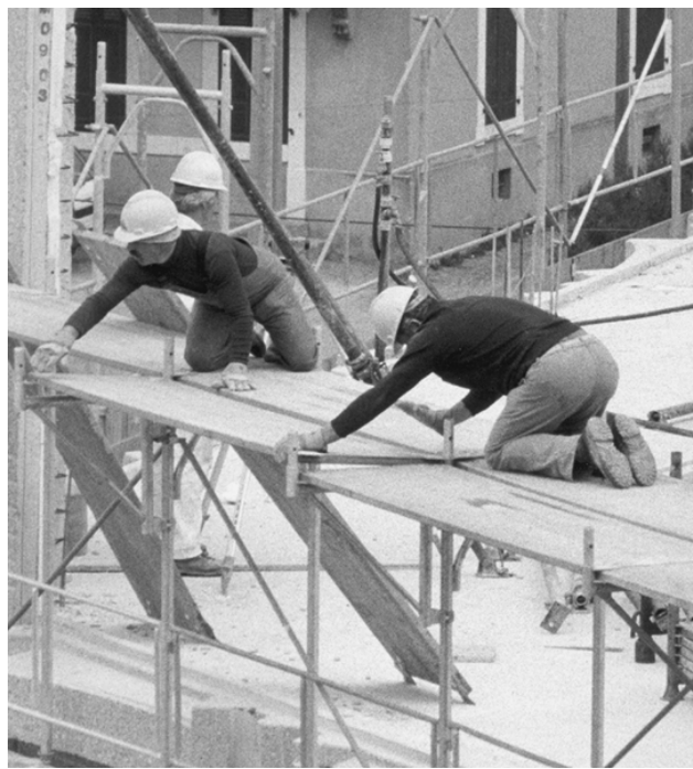
Figura 93.4 • Montaje de andamios en una obra en Ginebra, Suiza, sin las protecciones adecuadas.
